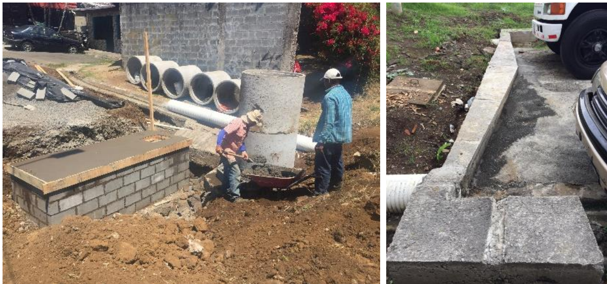
Izquierda: Etapa de construcción del prototipo “Sistema de atenuación para agua pluvial”. Derecha: Final de la calle de la urbanización Siglo XXI.
